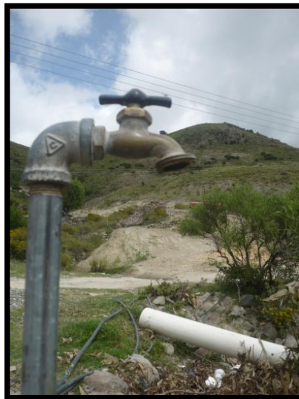
Figura 16.- Llave común de distribución, La Joya, 2010, LEG.
