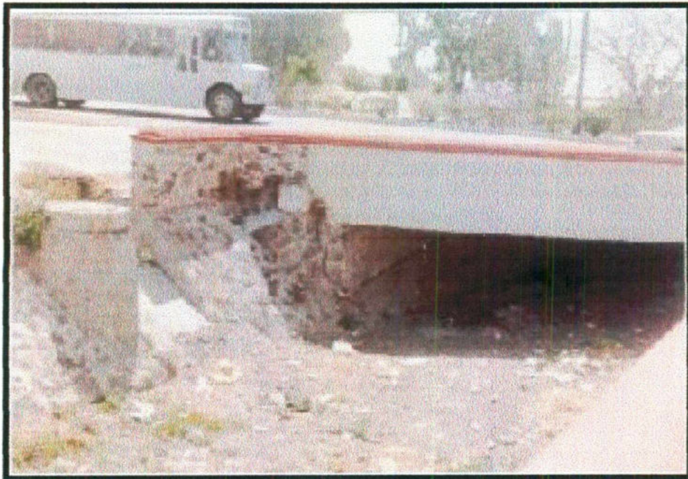
FOTO 10. Otra toma del dren Cimatario, son la misma problemática de sedimentos. Y esto se puede seguir viendo a todo lo largo de este dren.
