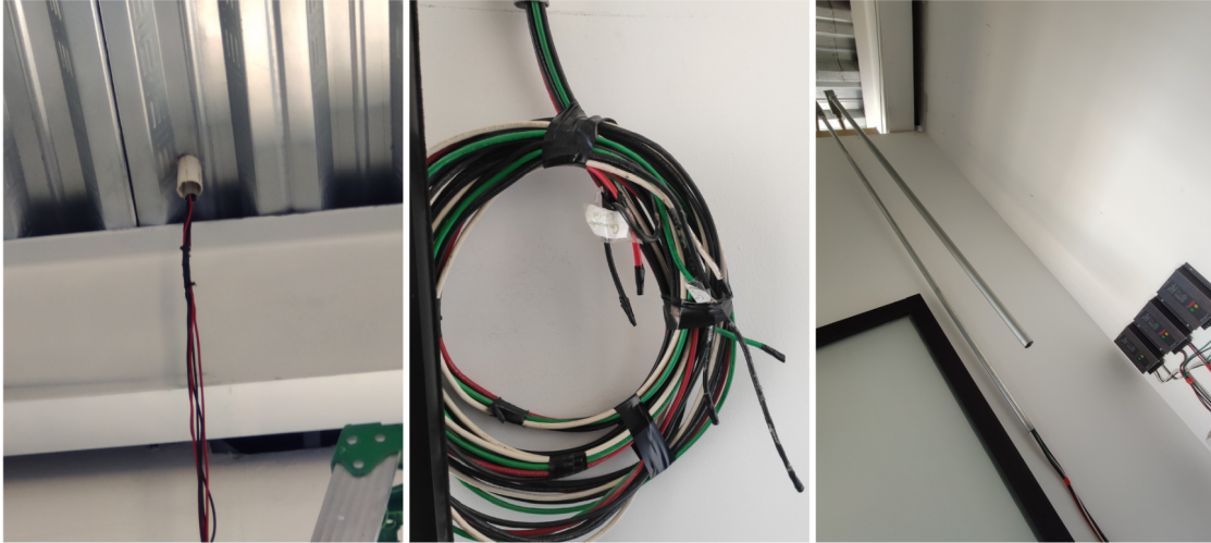
Figura 3.12. Canalización del conductor, desde el aerogenerador hasta el regulador (autoría propia).
