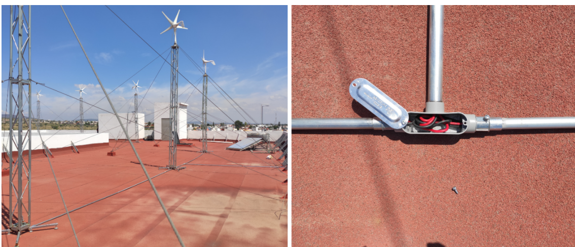
Figura 3.11. Canalización y conexión del conductor a la salida de las turbinas (autoría propia).
