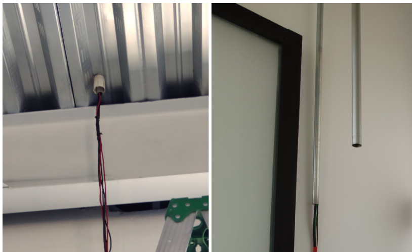
Figura 4.5. Áreas que ocupó el conductor eléctrico de la salida del aerogenerador (autoría propia).
