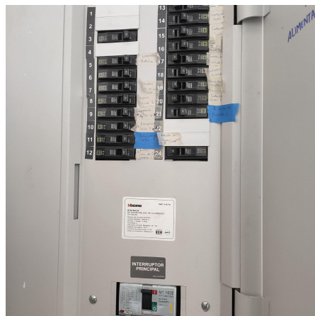
Figura 3.13. Tablero de baja tensión (autoría propia).
