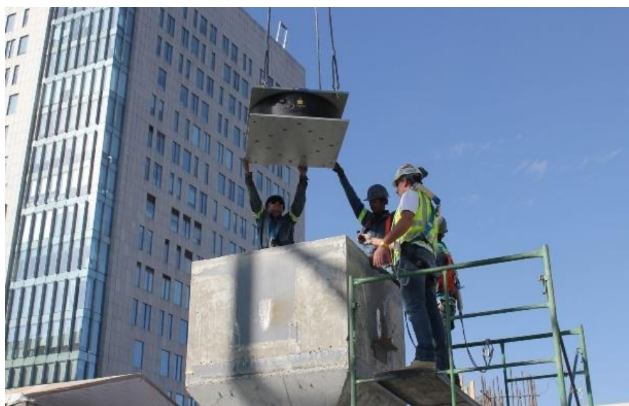
Figura 2.5. Aisladores en edificio de Espacio Condesa (Mageba, 2020).
