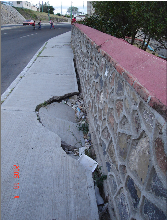
Figura 1.11 Inestabilidad del talud en la vialidad Boulevard de las Américas, frente al parque hundido en la ciudad de Querétaro
