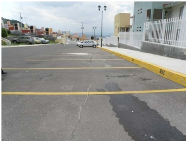
Figura 2.8 foto de grieta en estacionamiento.
