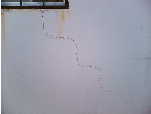
Figura 2.2 Agrietamiento en zigzag presentado cerca de una ventana
