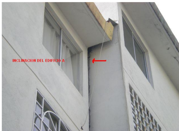
Figura 2.3 Foto en la que se observa la inclinación de uno de los edificios.
