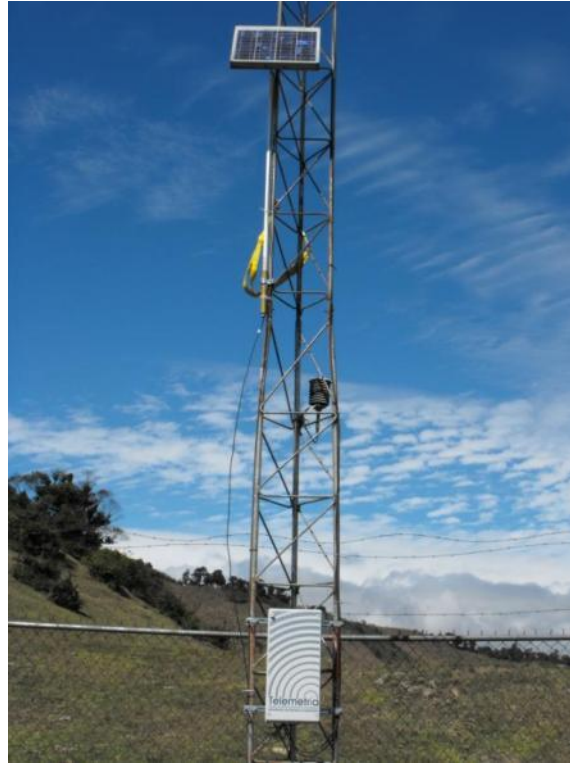
Figura 48 Estación de Telemetría Instalada en el Cerro de las Cruces, Chiapas.
