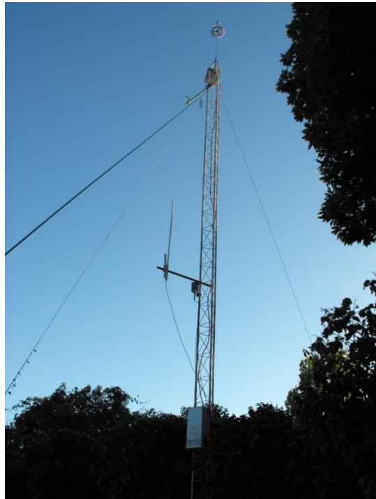
Figura 47 Estación de Telemetría Instalada en Nueva Victoria, Chiapas.
