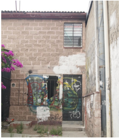
Fotografía 0:5 Vandalismo en vivienda abandonada, calle Matlazincas
