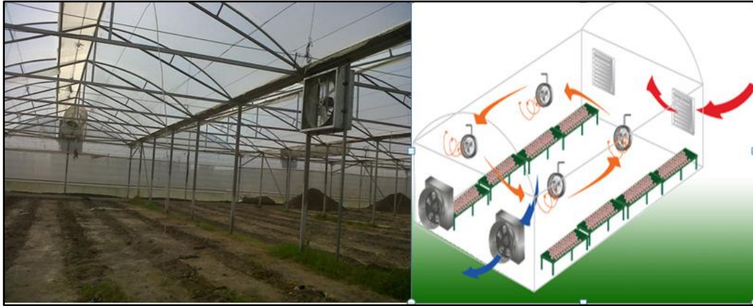
Figura 4. Ventilación mecánica en invernadero
