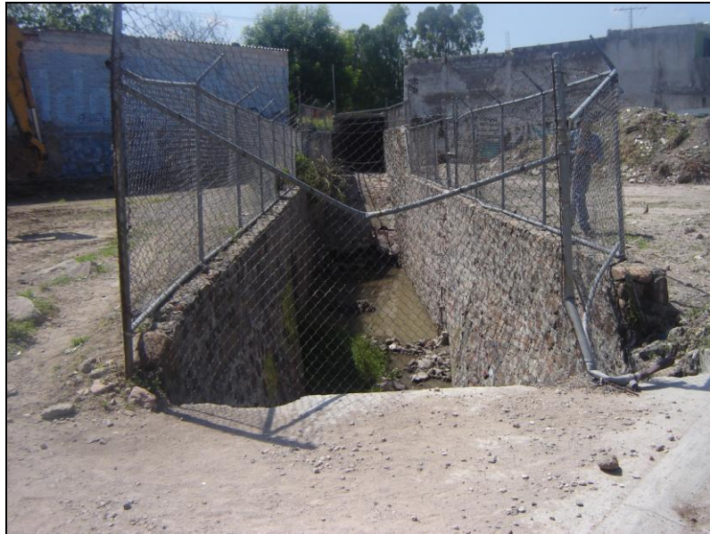
Figura 3.79. Vista del dren que baja por calle Zacatecas y el cual cuenta con altas pendientes lo que ocasiona erosión y arrastre de material sólido hacia aguas abajo.
