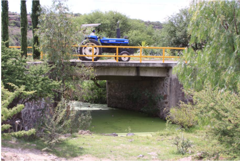
Figura 3.86. Puente que no corresponde a la capacidad hidráulica del arroyo.
