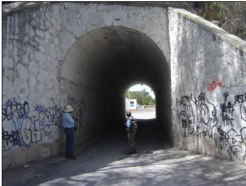
Figura 3.18. Vista de un paso vehicular, en donde actualmente se observan encharcamientos.
