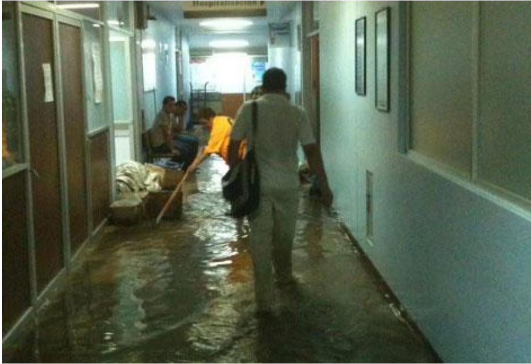
Figura 3.104. Inundación y afectación del Hospital General cuenca baja.
