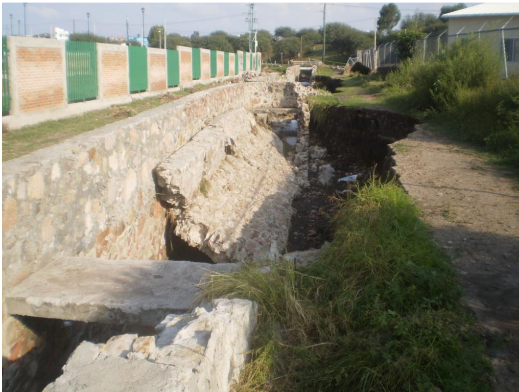
Figura 3.103. Afectaciones a dren cuenca baja.
