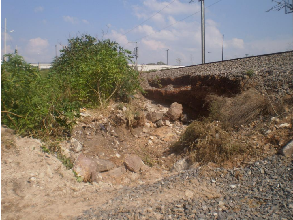
Figura 3.100. Afectaciones a alcantarillas cuenca alta-media.
