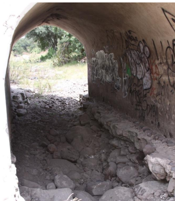
Figura 3.91. Puente vehicular, de acuerdo al comportamiento de los escurrimientos de agua.
