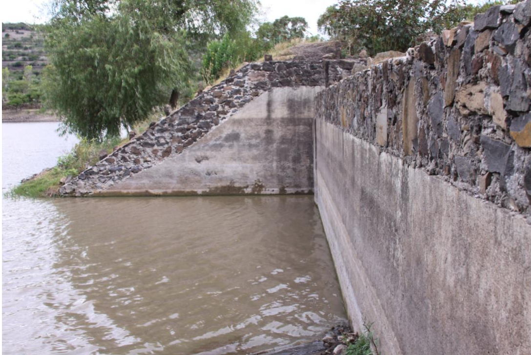
Figura 3.84. Bordo de regulación, Paso de Mata, presenta alteración en capacidad.
