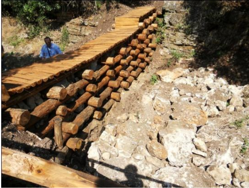
Figura 6.3. Construcción de presa filtrante de tronco y roca acomodada, obra de ingeniería naturalística. Fuente: Experiencia práctica, Provincia de Foggia, Sur de Italia, 2011.
