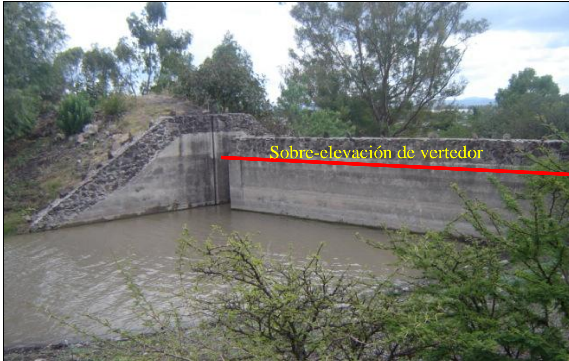
Figura 3.33. Vista general de vertedor por margen derecha, que ha sido sobrelevado, poniendo en riesgo la seguridad de la estructura.
