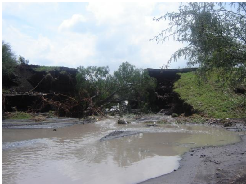
Figura 3.77. Vista de la abertura generada en el bordo Juárez en la temporada de lluvias de Septiembre de 2010.
