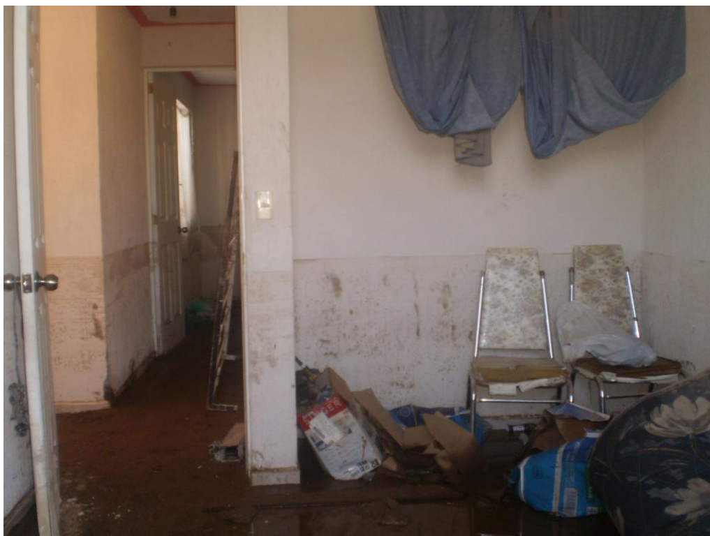
Figura 3.107. Inundación y afectación a zonas habitacionales cuenca baja.
