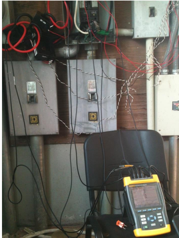
Figura 35: conexión del FLUKE 434.
