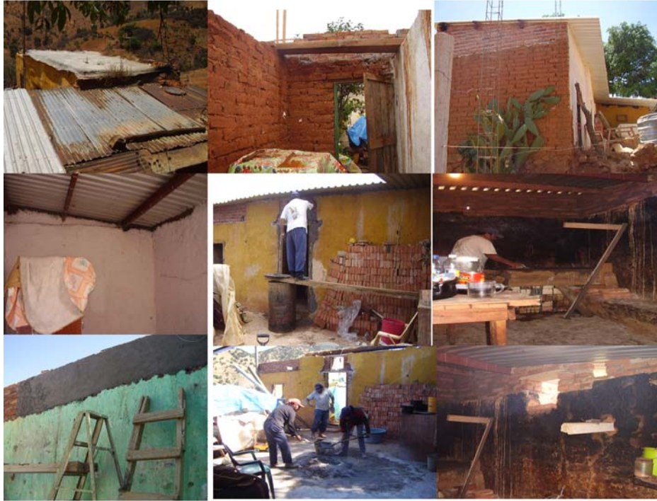
Figura 30. Derrumbe y reconstrucción de techos
