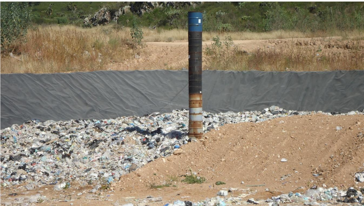
Imagen 31.-Vista general de la Lona de Caucho y una chimenea hecha de barriles apilados, los cuales sirven de como conductos de ventilación.
