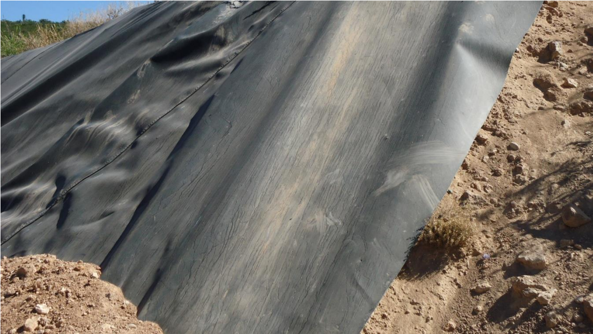
Imagen 30.- Material utilizado como recubrimiento del depósito de residuos en el relleno sanitario (el cual los aísla del subsuelo). Material: Caucho Automotriz
