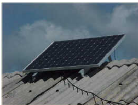
Figura 2.7 Panel solar fotovoltaico instalados en techos electrificados con el sistema híbrido descrito.
