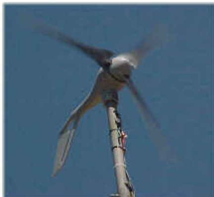
Figura 2.6 Aerogenerador, modelos AIR 403, utilizados en los sistemas híbridos eólico-fotovoltaicos que ya funcionan con éxito.
