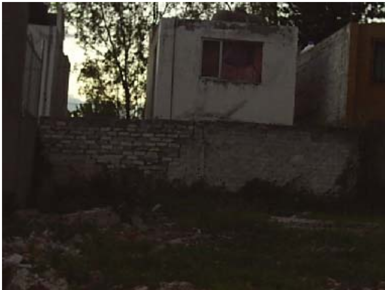
Foto VIII.7 Casa ubicada en la colonia “Ensueño”, con daño estructural Grieta 4 (“Jardines”)
