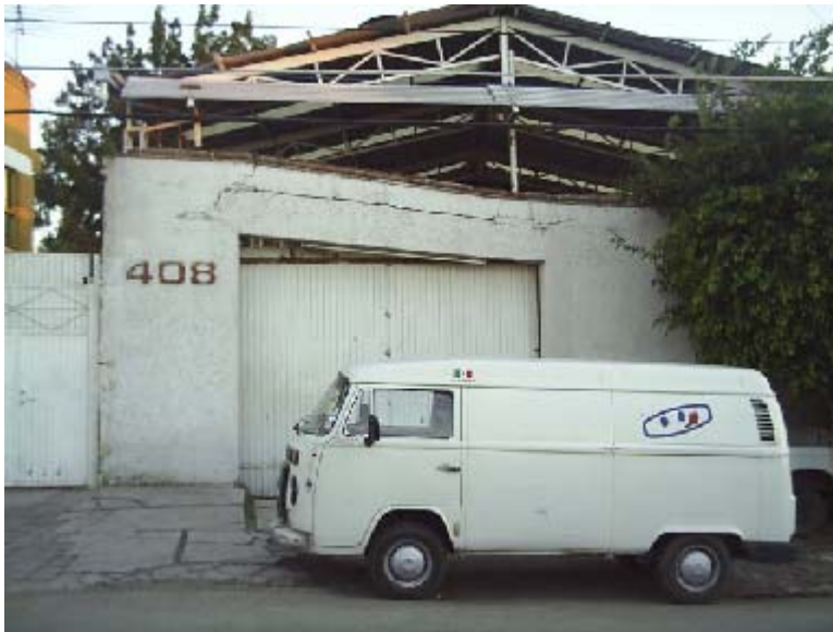
Foto VII.5 Inmueble ubicado en Calle Prol. Pino Suárez, Grieta 4 (“Jardines”)
