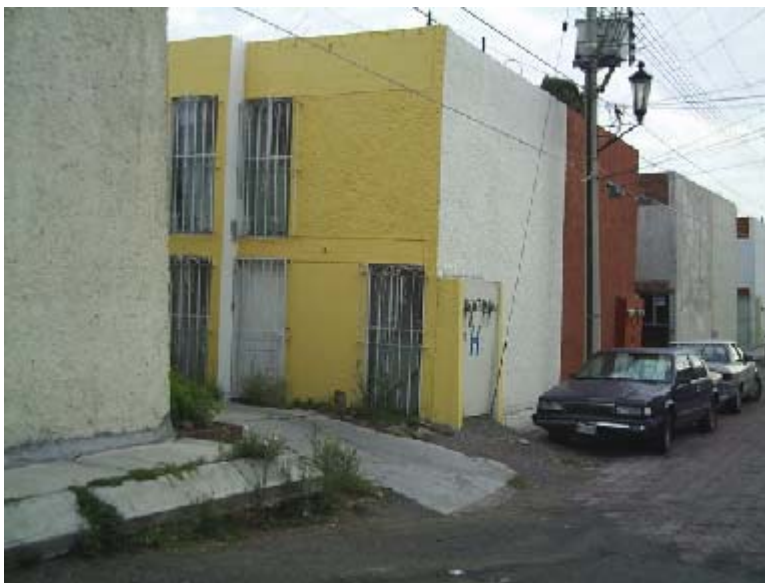
Foto VIII.13 Casa en Condominio Hacienda Grande, afectada por la Grieta 4 (“Jardines”)
