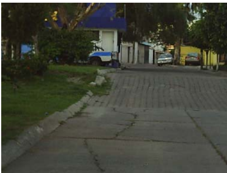
Foto VIII.6 Cruce de la Grieta 4 (“Jardines”) por Calle Vicente Acosta, el la Colonia “Ensueño”
