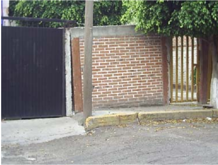
Foto VIII.14 Casa Habitación en calle Hacienda El Lobo, afectada por la Grieta 4(“Jardines”)
