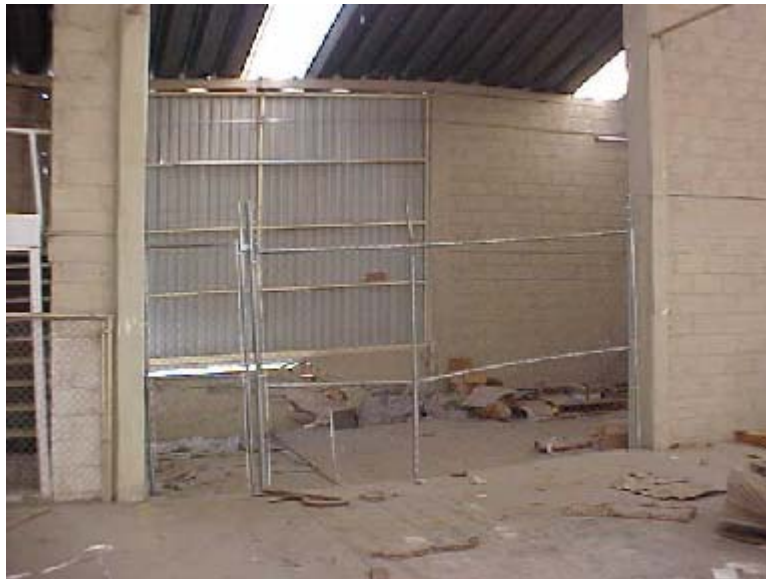
Foto VIII.1 Inmueble ubicado en Avenida 5 de Febrero(Grieta 1)
