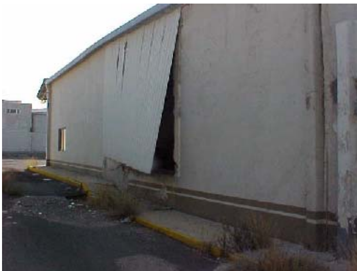
Foto I.1 Ejemplo de afectación por grieta
