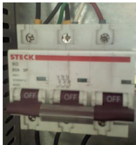
Figura 3.1. Switch de alimentación principal.
