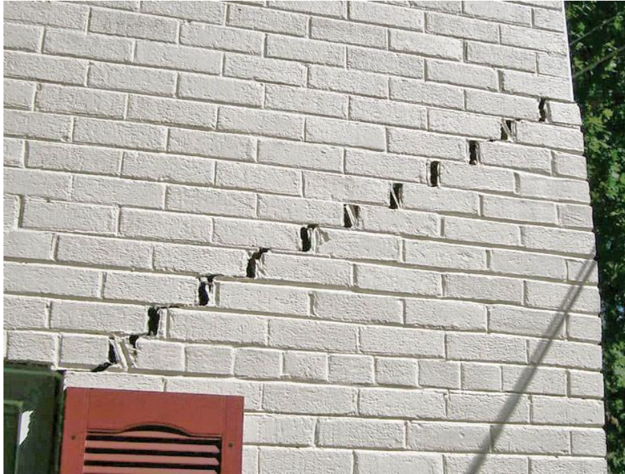
Figura 2-2. Grieta producida por un suelo expansivo (Roland, 2015).
