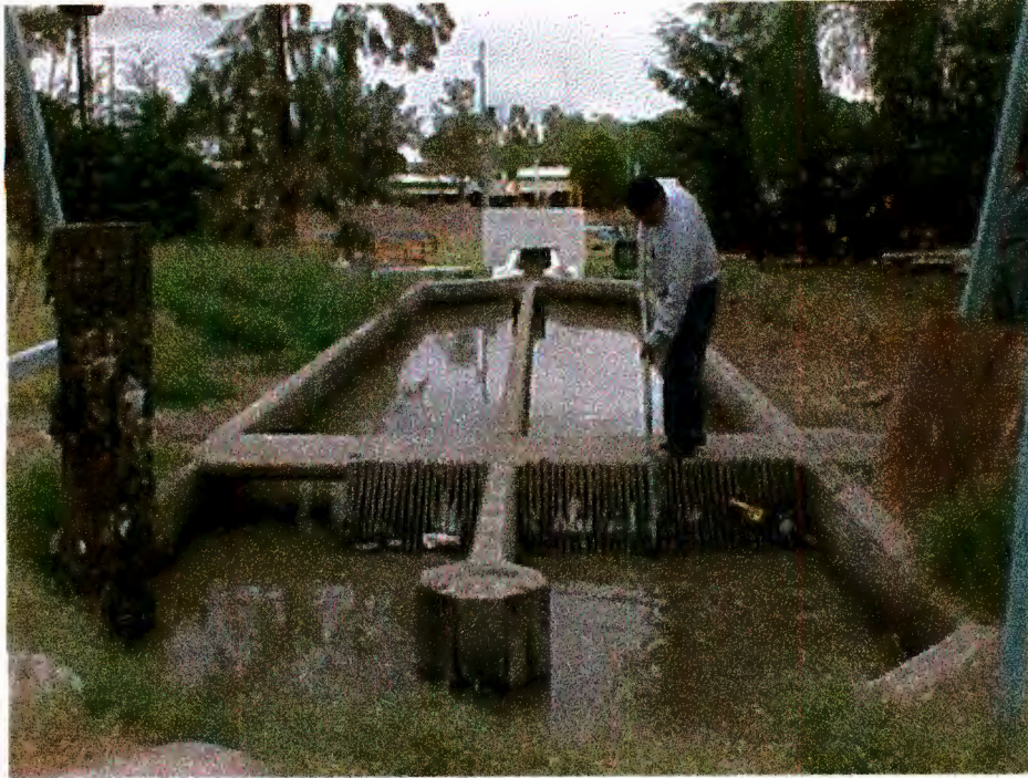
FIGURA 4.2 Entrada del agua residual a la planta de tratamiento (desarenador)
