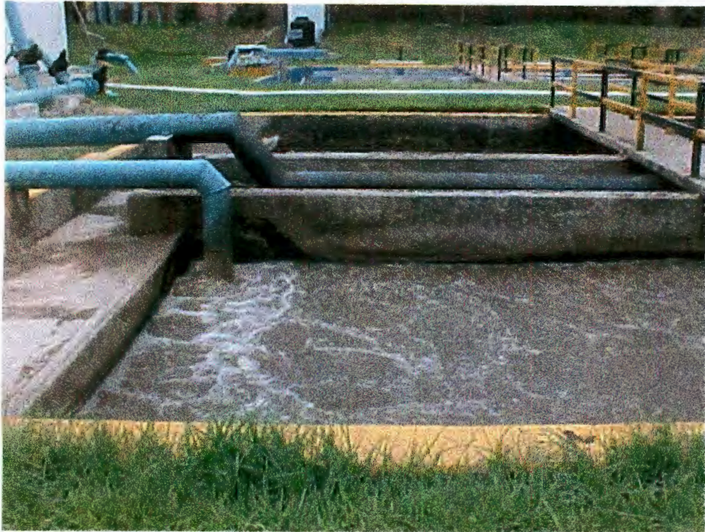
FIGURA 4.4 Tanque de aireación y recirculación de lodos
