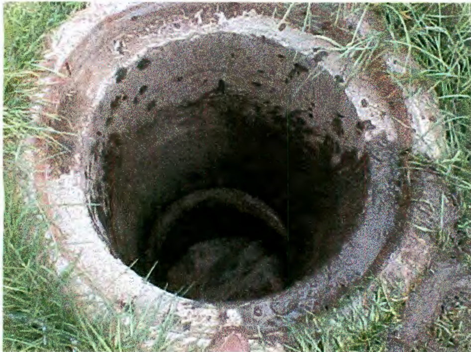
FIGURA 4.5 Pozo de lodos para su recirculación
