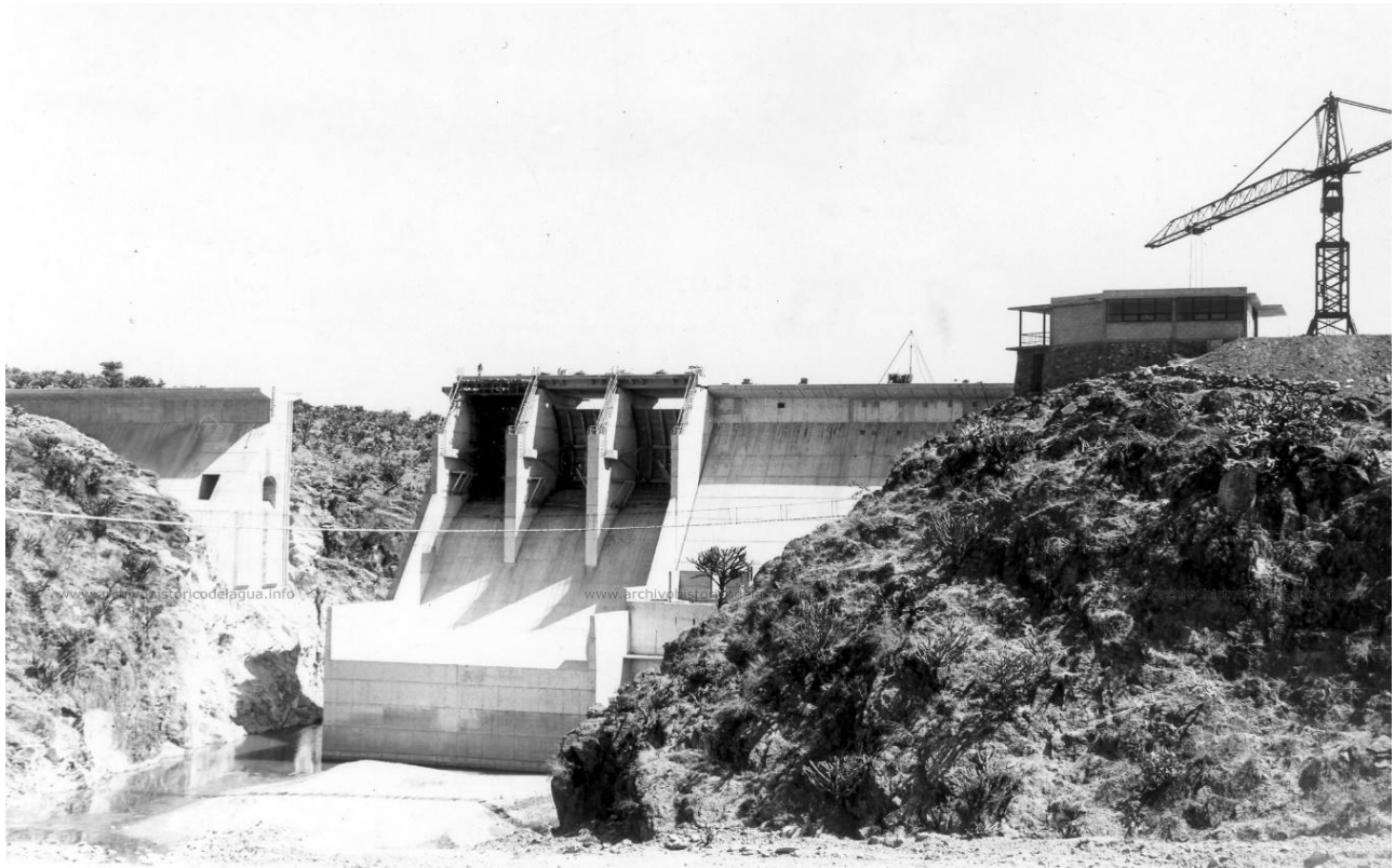
Fotografía 5. Construcción de la cortina de la presa Ignacio Allende en abril de 1967.
