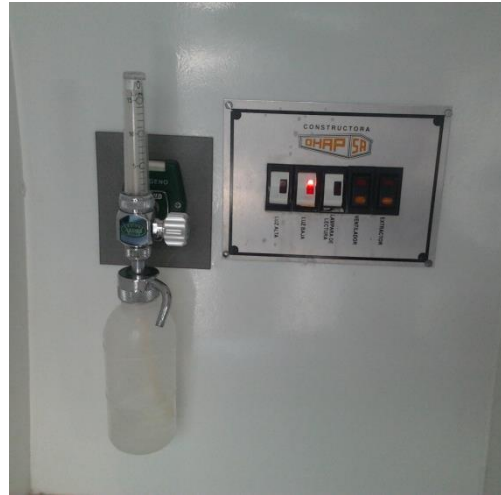
Ilustración 23 Toma de agua, aire y control de ambiente
