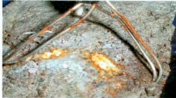
Figura 28. Productos de corrosión del ánodo de sacrificio.
