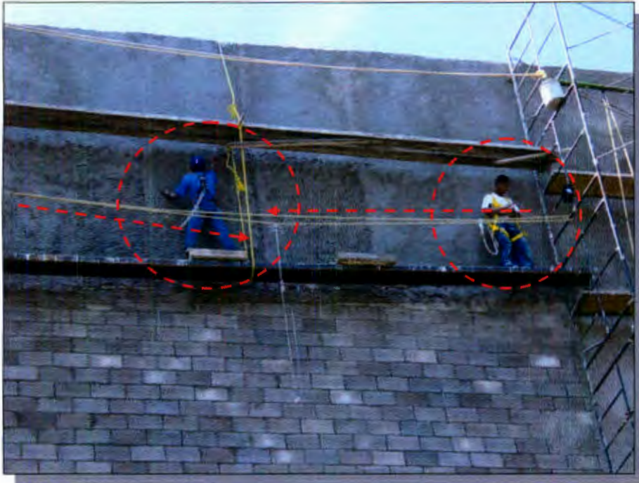
Fig. 4.11 Condiciones finales de la línea de vida y uso de equipo para prevención de caídas en trabajos no prolongados colocadas de manera provisional
