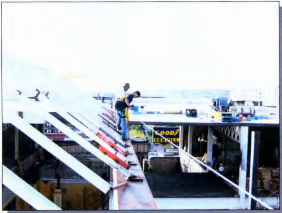
Fig. 4.7 Supervisión de las condiciones de la línea de vida al perímetro del domo
