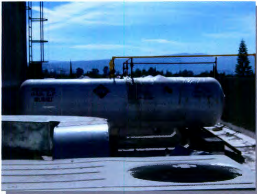
Fig. 2.7 Tanques de aprovechamiento de gas LP con capacidad de 5000 lt para suministro de Sport City
