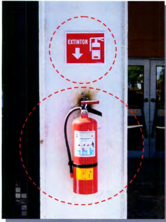
Fig. 5.1 Extintor de Polvo Químico Seco, 6 Kg de capacidad
