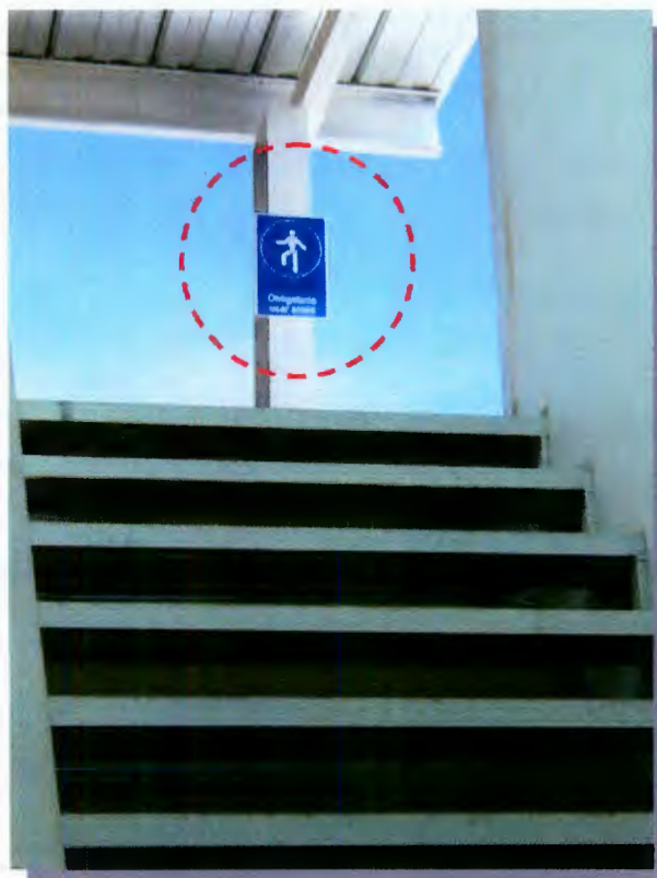
Fig. 5.3 Señalización de tipo obligatorio para condiciones de seguridad al interior de la obra
