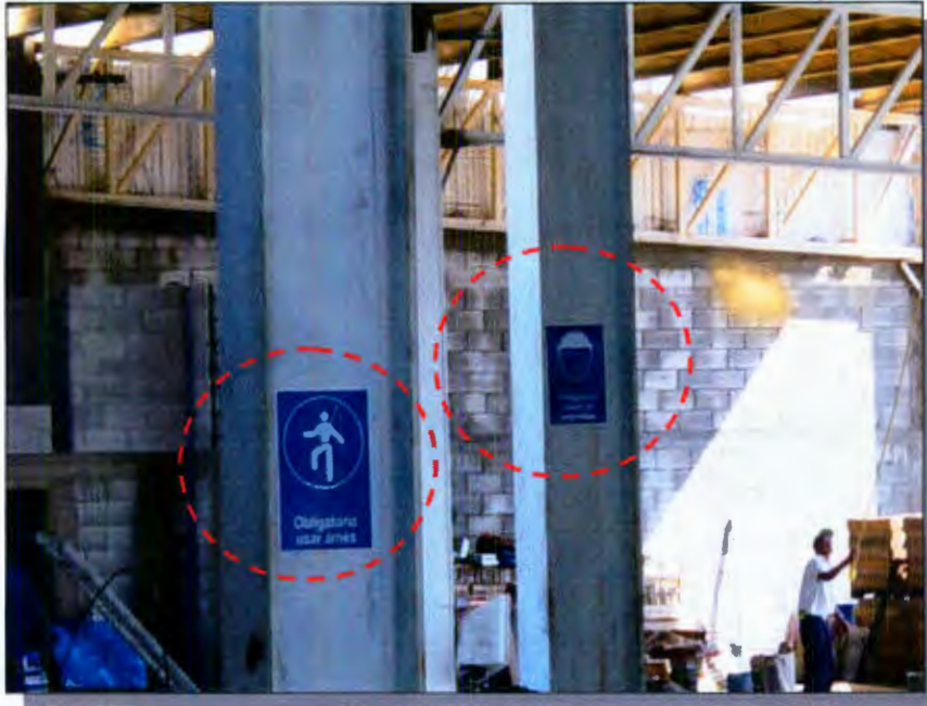
Fig. 5.2 Señalización de tipo obligatorio para condiciones de seguridad al interior de la obra
