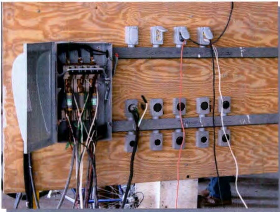
Fig. 2.3 Condiciones de los tableros al inicio de la supervisión.
