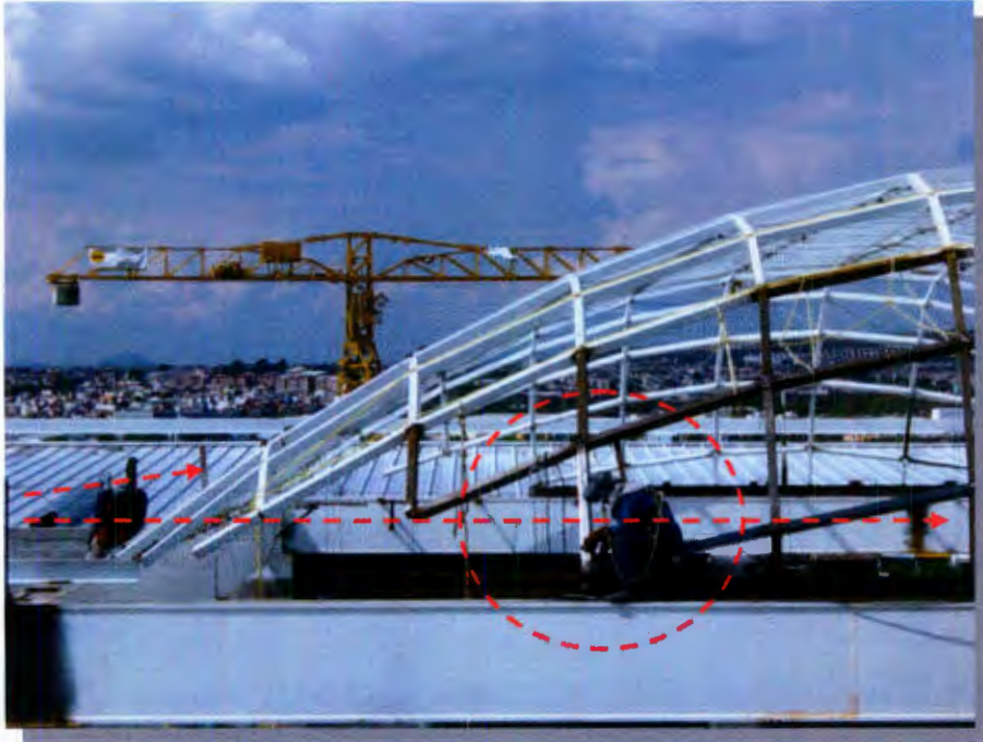
Fig. 4.5 Modo y empleo de líneas de vida y equipo de seguridad para soldadura en el perímetro del domo
