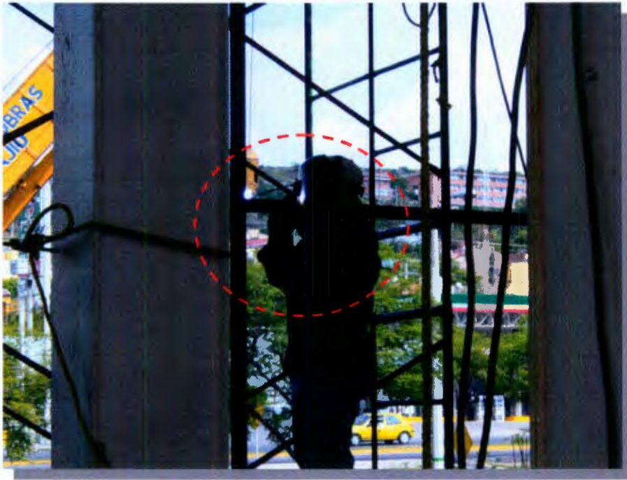
Fig. 2.2 Soldador en actividad normal, utilizando guantes y careta para soldar
