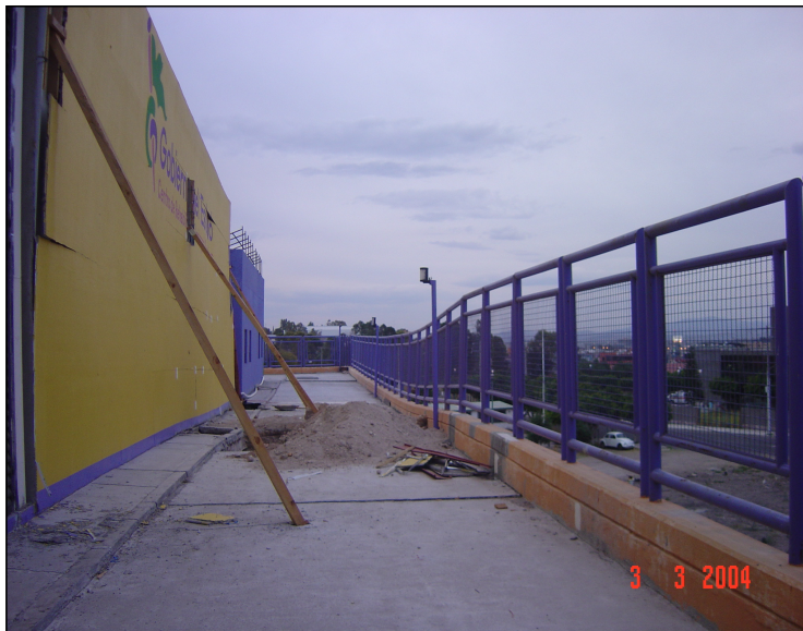
Figura 1.1 Foto en la que se aprecian los daños presentados en el CRIQ
