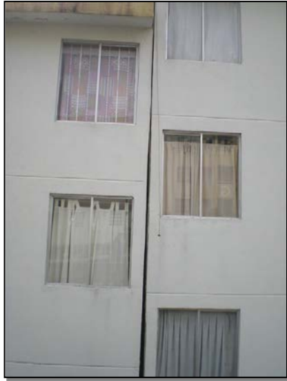
Figura 2.6 Inclinación de uno de los edificios de estudio
