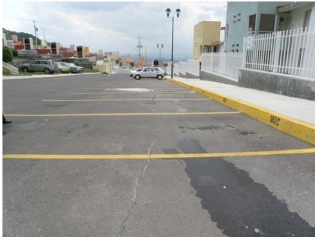
Figura 2.8 foto de grieta en estacionamiento.
