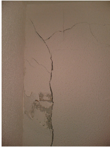
Figura 2.7 foto de un agrietamiento interior en uno de los edificios
