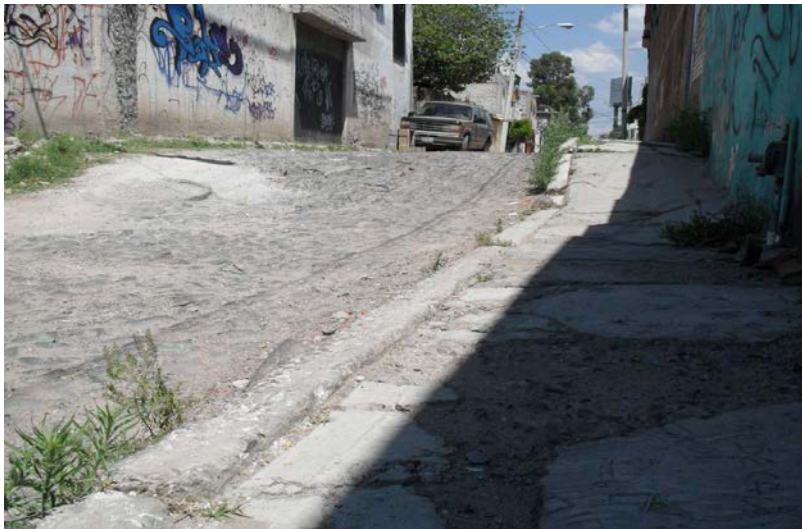
Figura 1.13 fotografía que muestra un hundimiento del terreno
