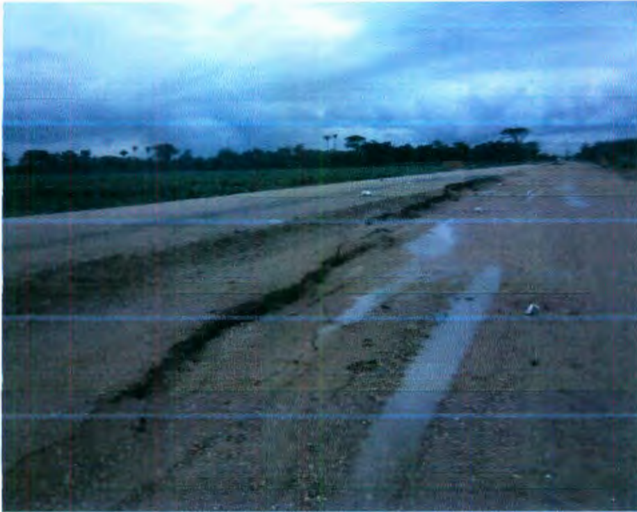
Figura A.1 Falla presentada en la sub-base, lado izquierdo.
