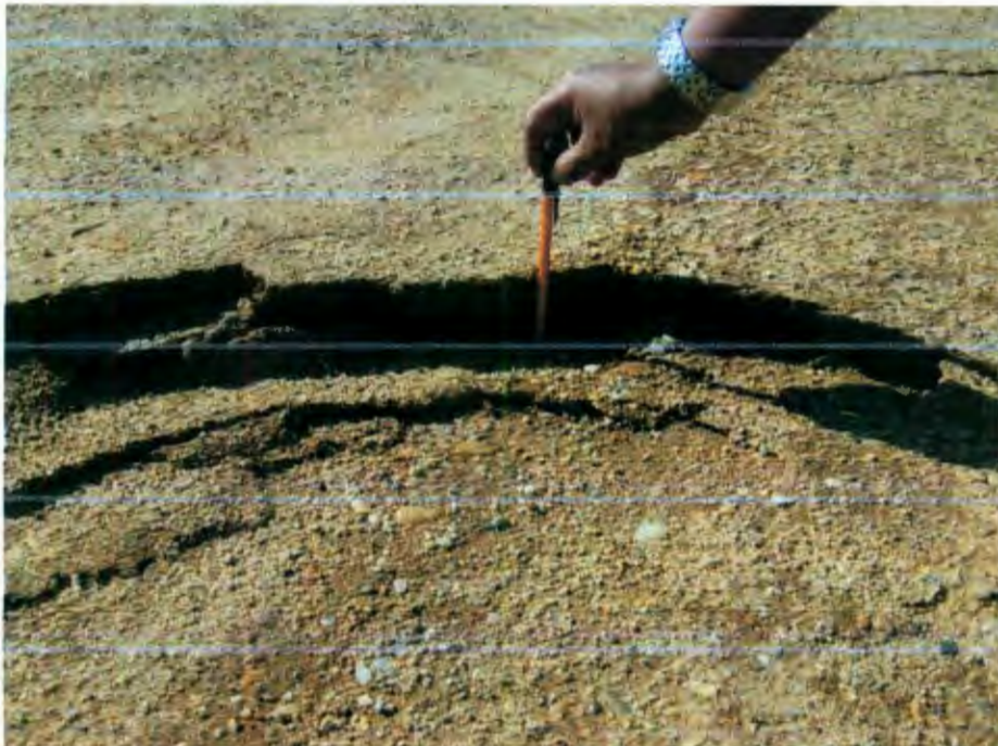
Figura A.4 Falla presentada por la falta de capacidad de carga del terreno pantanoso.
