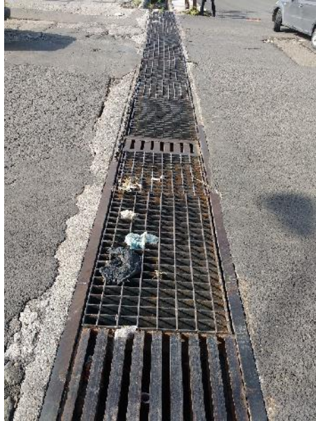
Fotografía 1. Entrada de agua no considerado inicialmente (Calle Santiago de Querétaro y Portal de Samaniego)
