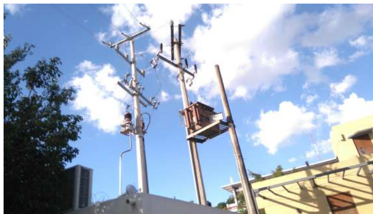
Figura 3.2: Transformador de subestación analizada.
