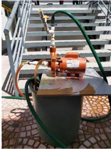
Figura 38 sistema de conexión bomba- CCP en sistema cerrado.
