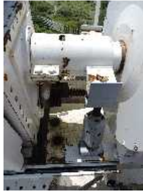
Figura 13. Eje del generador.
