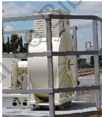
Figura 20. Sistema de refrigeración.
