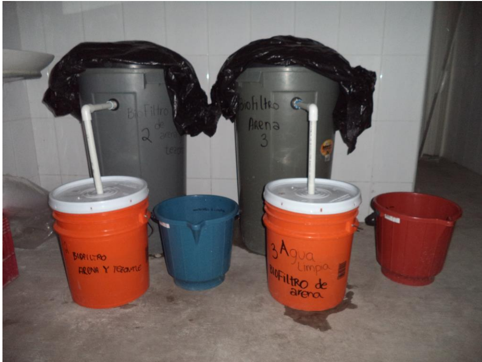
Figura 4-3. Fotografía de los biofiltros 2 y 3 instalados.
