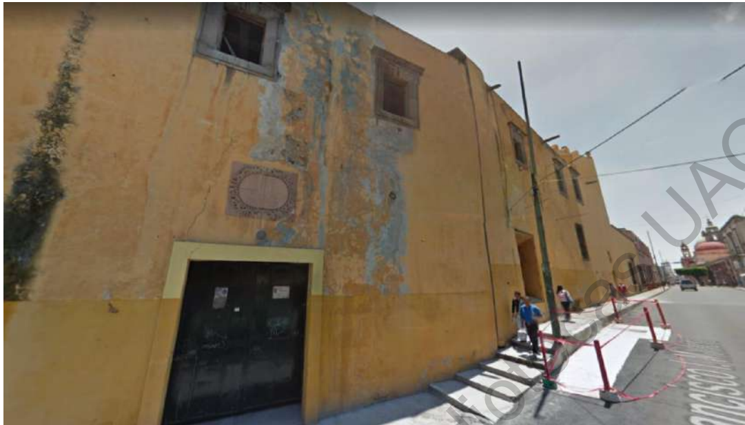
Fotografía 2.2: Vista posterior del convento de San Francisco de Celaya, calle Madero. Una falla cruza por el convento provocando el hundimiento diferencial del terreno, como se aprecia de izquierda a derecha. Por su parte, el INAH intervino el edificio en los años ochenta realizando un corte para evitar el colapso total del edificio. Imagen tomada de Google.maps.
