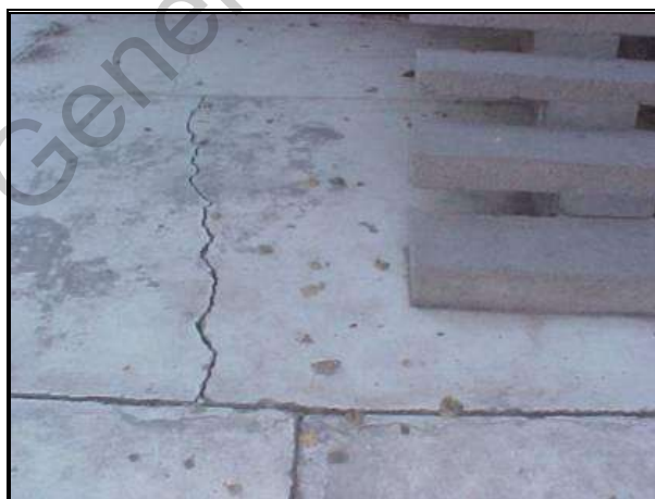
Figura III.2 Daño en un piso causado por la expansión del suelo.
