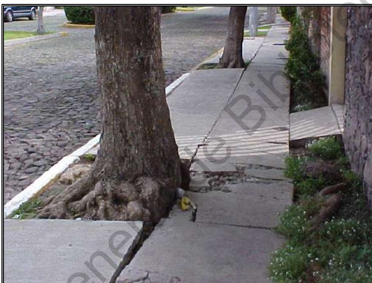
Figura III.1 Daños causados por la vegetación.
