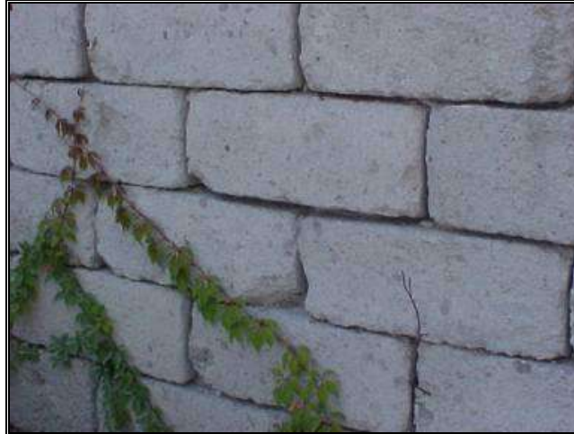
Figura IV.9 Muro de sillar con junta pobre.
