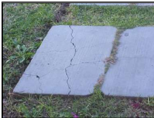
Figura IV.1 Daño irreparable en una huella de concreto.
