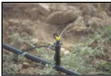
Figura II.21 Riego por goteo.
