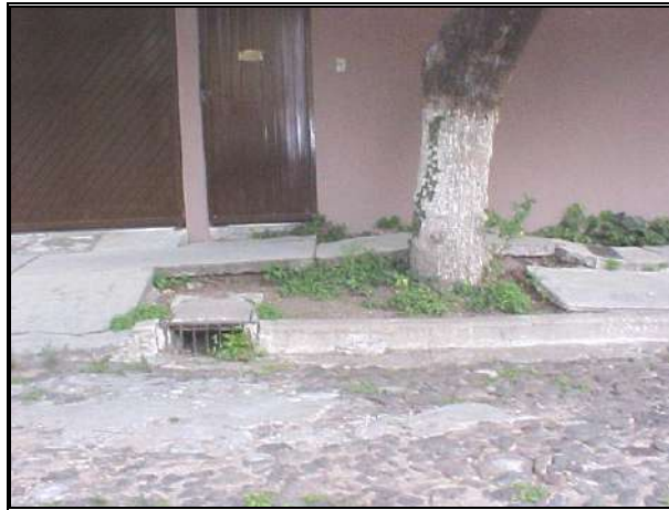
Figura III.3 Daño en banqueta causado por un árbol.
