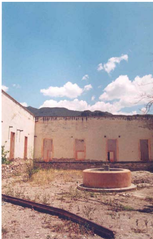
Foto 8. Segundo patio del Coristado, apréciase el estado de abandono en el que se encuentra.
