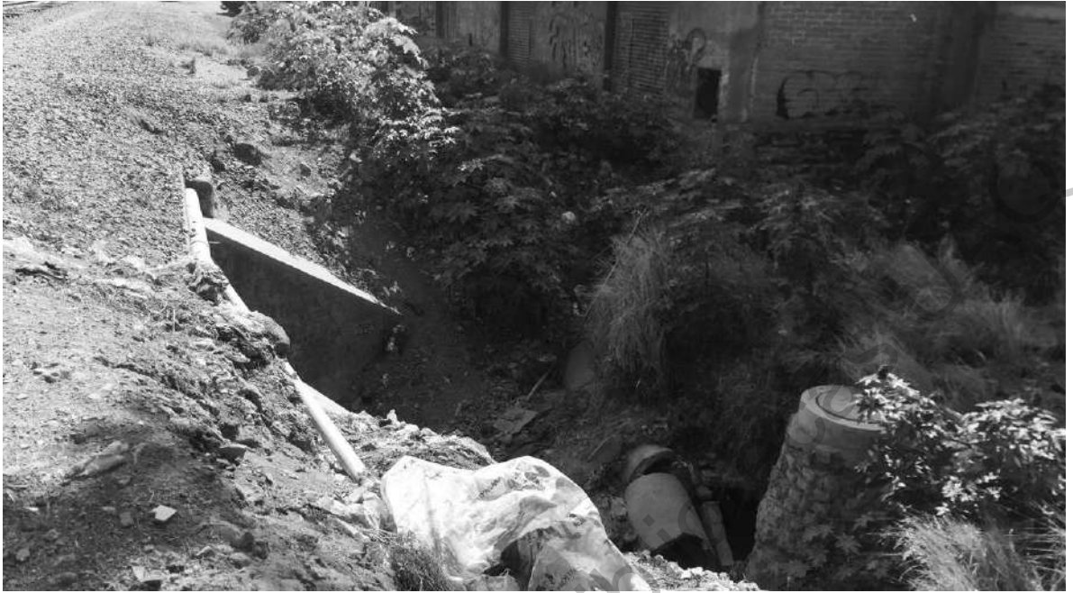
Fotografía 24. Drenaje: autoría propia (tomada en 2018-03-27).
