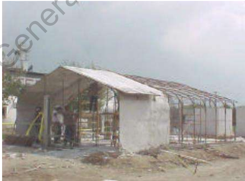
Fig. 4 Zarpeo de la estructura metálica de una Tecnocasa, (Yeomans et al. , 2000).
