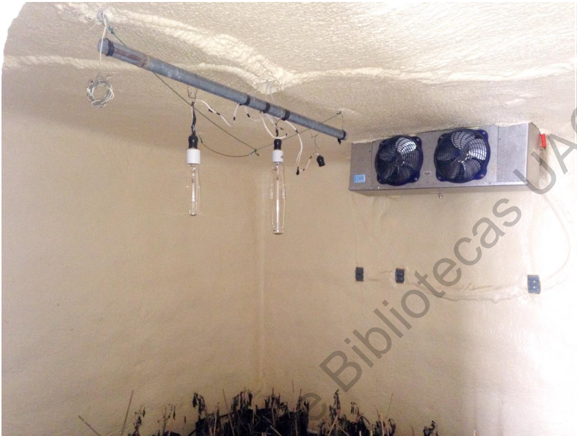
Figura 4.4. Fotografía del interior de la cámara climática externa (C2).
