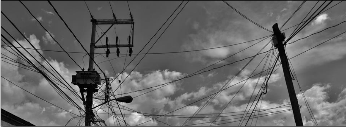
Figura 3 Cables, colonia Las Américas, Querétaro.
