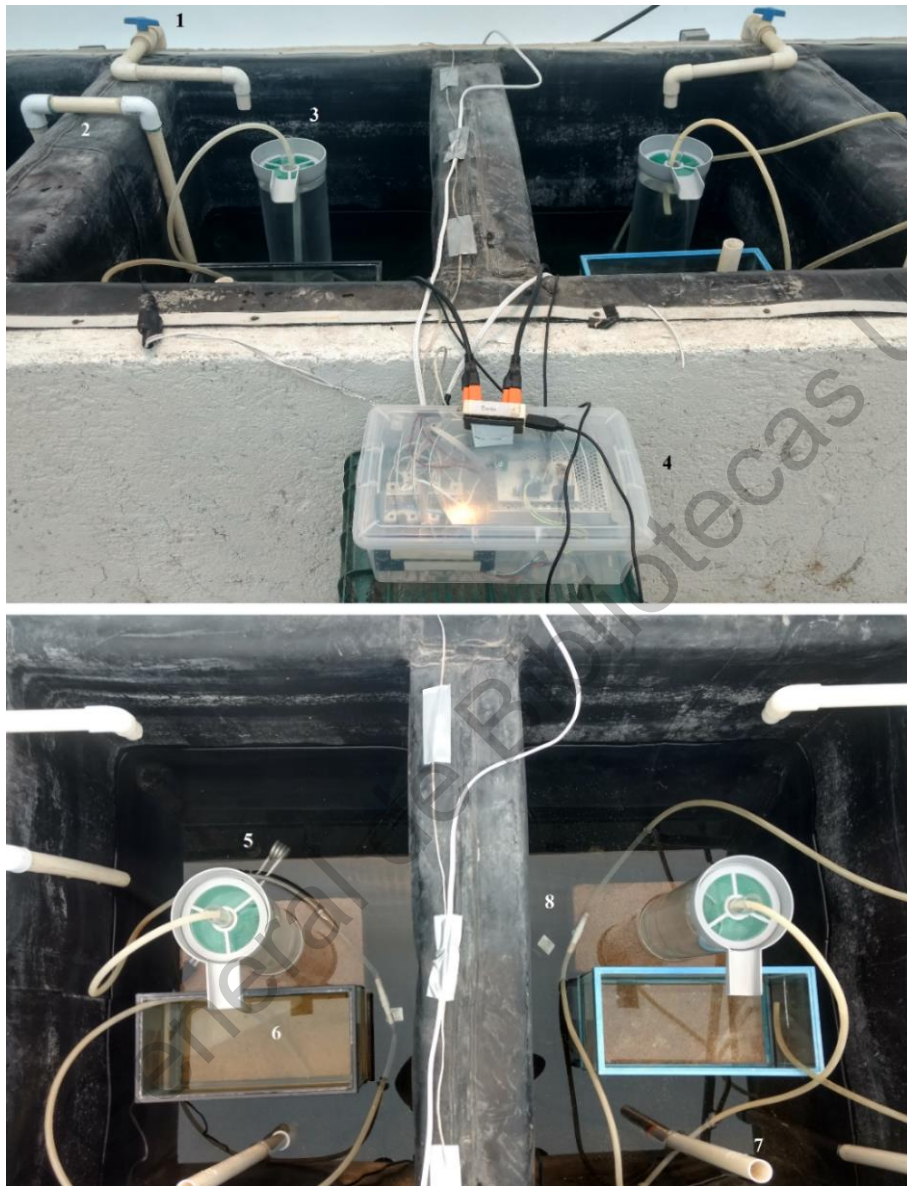
Figura 14. Sistema instalado en estanques del invernadero acuícola de la UAQ Amazcala.
