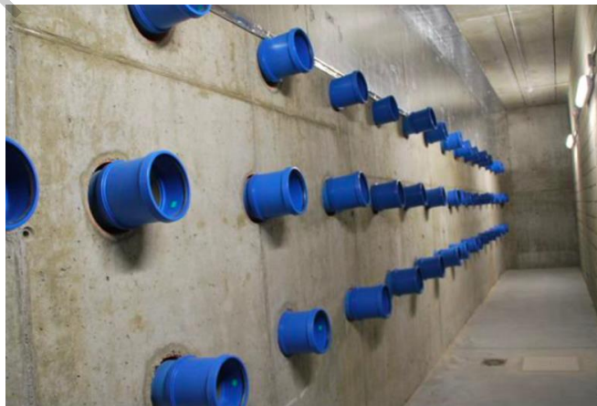
Figura 21 Imagen de la salida de aire de los pozos a la cavidad anterior a la UTA (Barbado, 2016).
