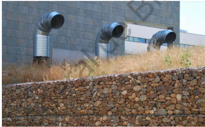
Figura 20 Toma de aire a la entrada de la instalación (Barbado, 2016).
