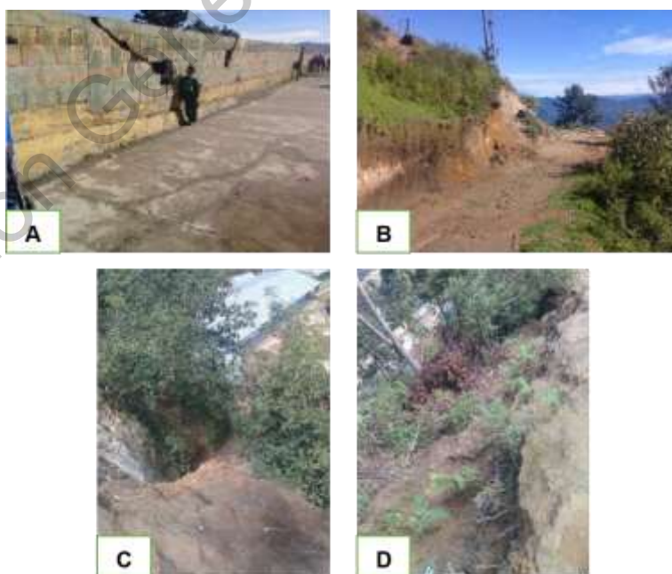
Figura 14: A. Daños infraestructura en escuela, B. desprendimiento de suelos en caminos, C. Desprendimiento de paredón y D. Hundimiento en paredón.
