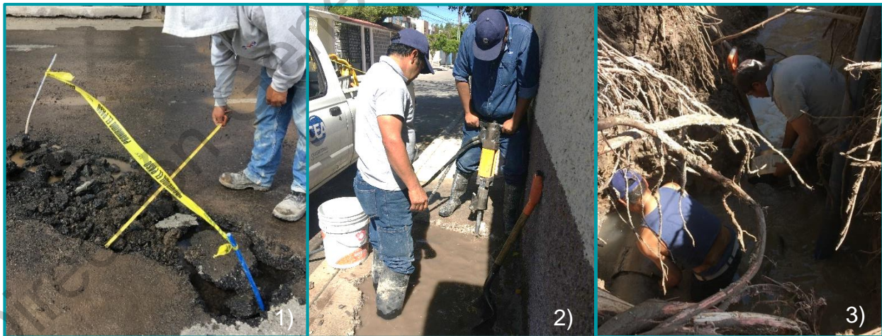
Figura 15. 1) Fuga no visible que no pudo ser reparada por la brigada. 2) Fuga en “arroyo”. 3) Fuga en línea de distribución que requirió retroexcavadora. Fotografías de KJOR.
