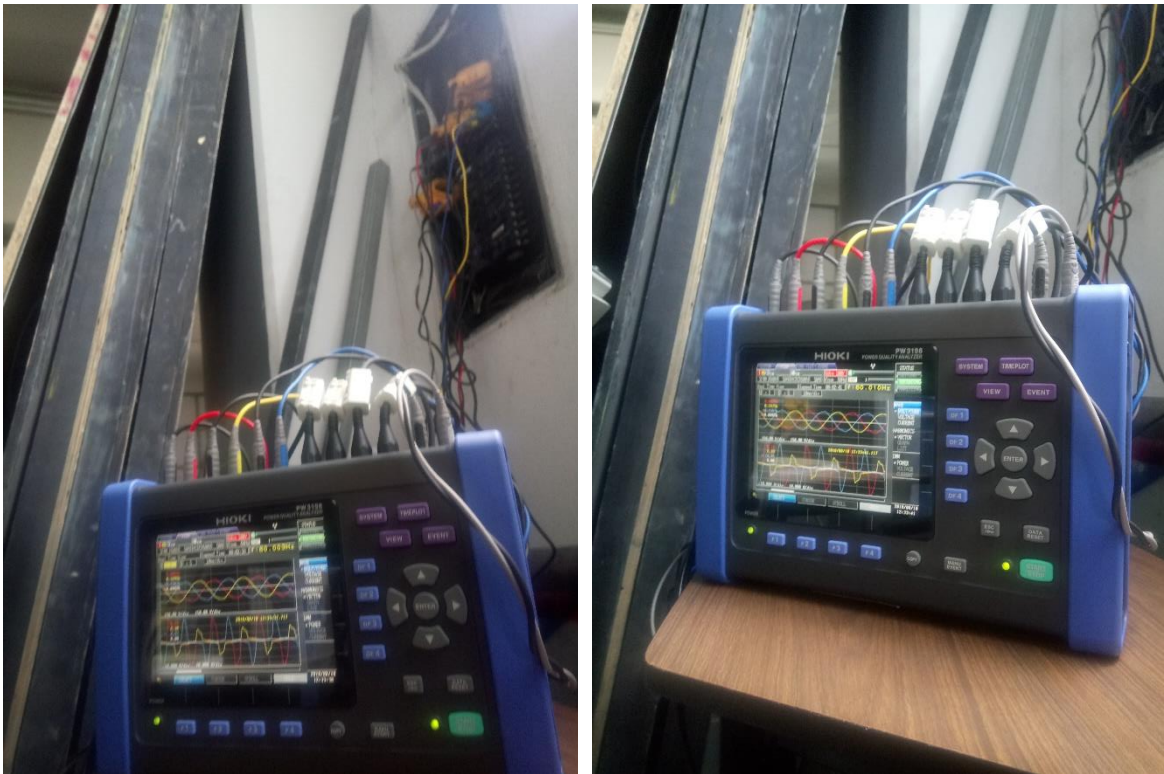
Foto 3. Analizador de calidad de la energía colocado por tres días seguidos.
