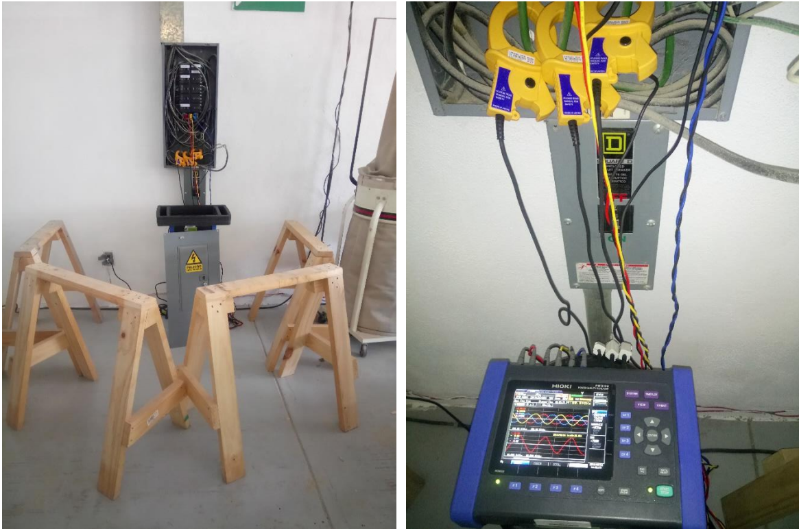
Foto 4. Conexión en el edificio CEDIT para simular las cargas que generan perturbaciones.
