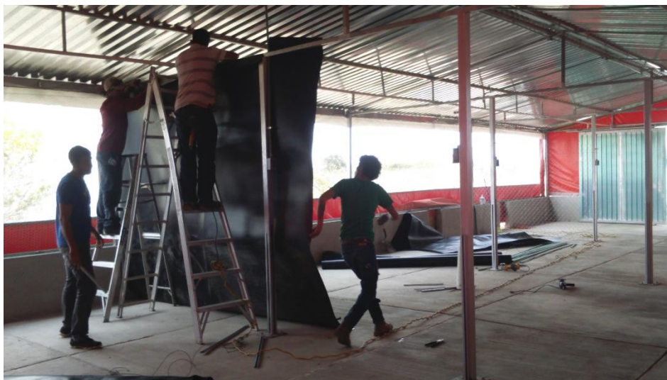
Figura 4. Instalación de la geomembrana dentro de la caseta avícola para la división de los gallineros.
