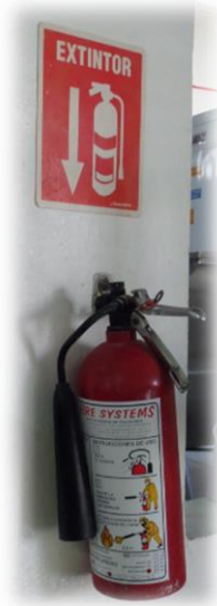
Figura 5 Señalética del extintor en la planta productora
