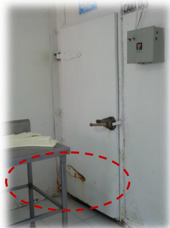
Figura 7 Puerta de la cámara de refrigeración
