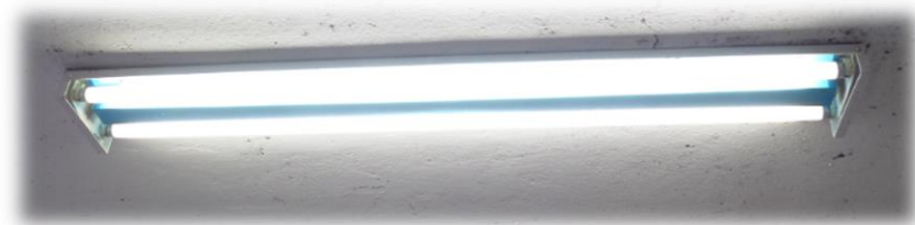
Figura 2 Lámpara colocada sobre el techo, sin protección
