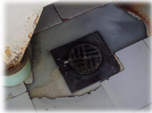
Figura 9 Piso roto en el área 2
