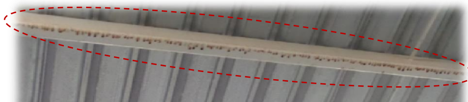
Figura 1 Techo de la planta productora, con escurrimientos
