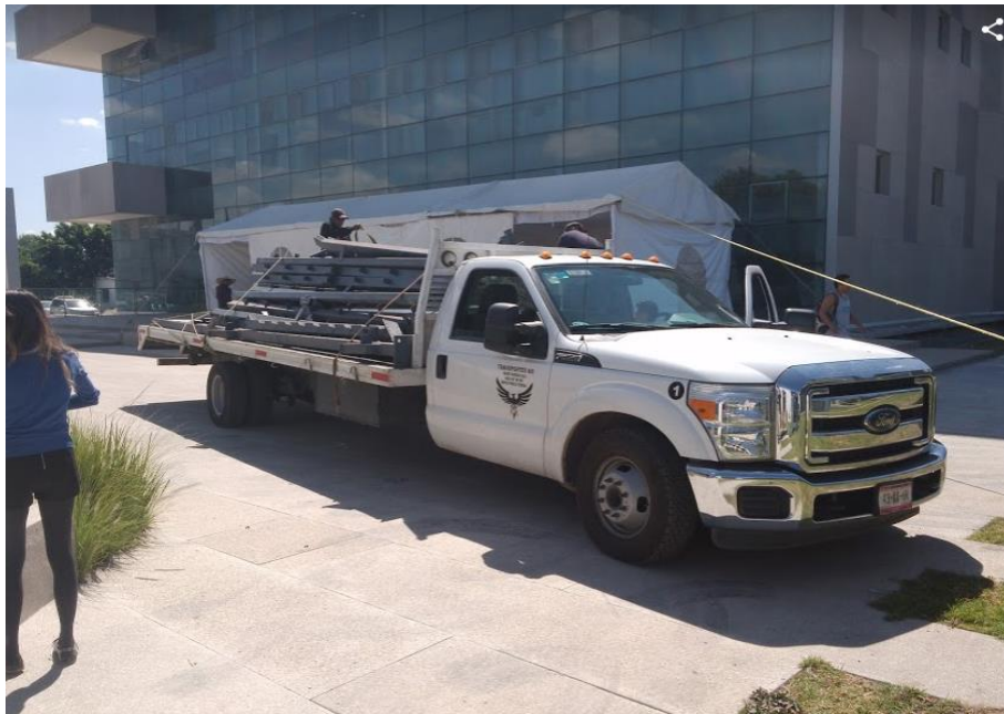
Figura 5-17.- Traslado de los elementos que conforman la estructura al sitio donde se realizará el montaje
