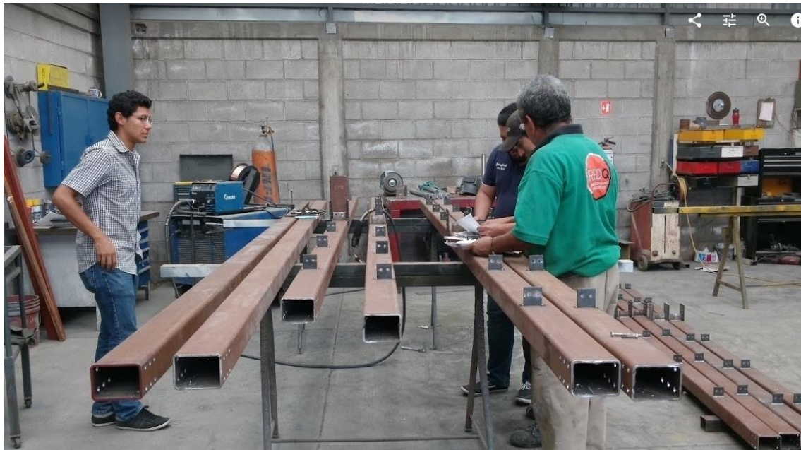
Figura 5-11.- Fabricación de vigas principales y unión de placas de cortante para conectar montenes.
