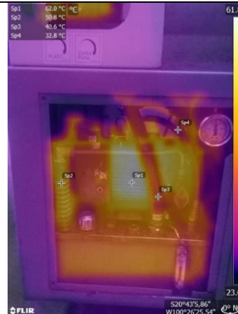
Figura 32. Térmica del sistema de enfriamiento de aceite
