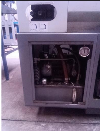
Figura 31. Del sistema de enfriamiento de aceite
