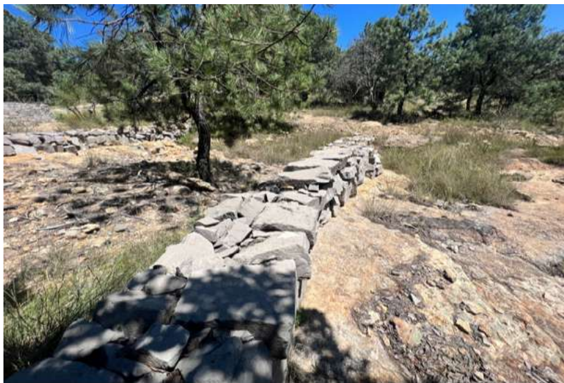
Figura 22. Presa de gaviones localizada en el sitio 1, la diferencia de color se debe a que la roca no pertenece al sitio intervenido.
