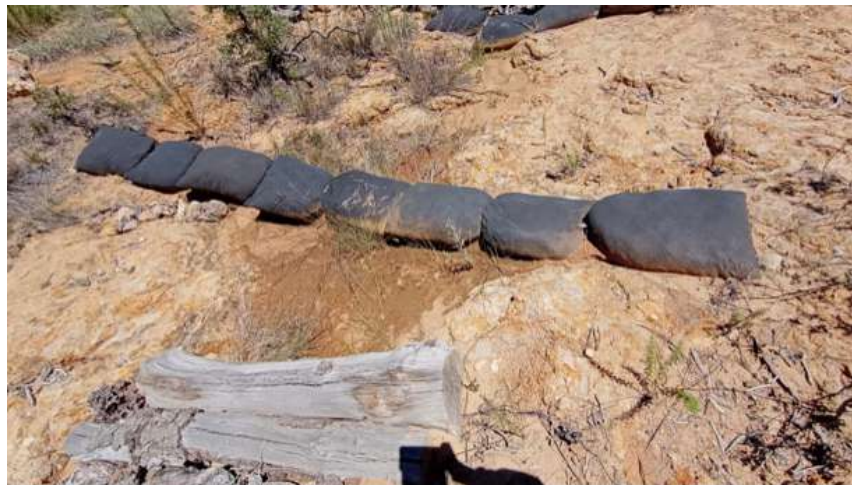
Figura 26. Geocostales sin empotrar donde el geotextil se observa en buen estado.
