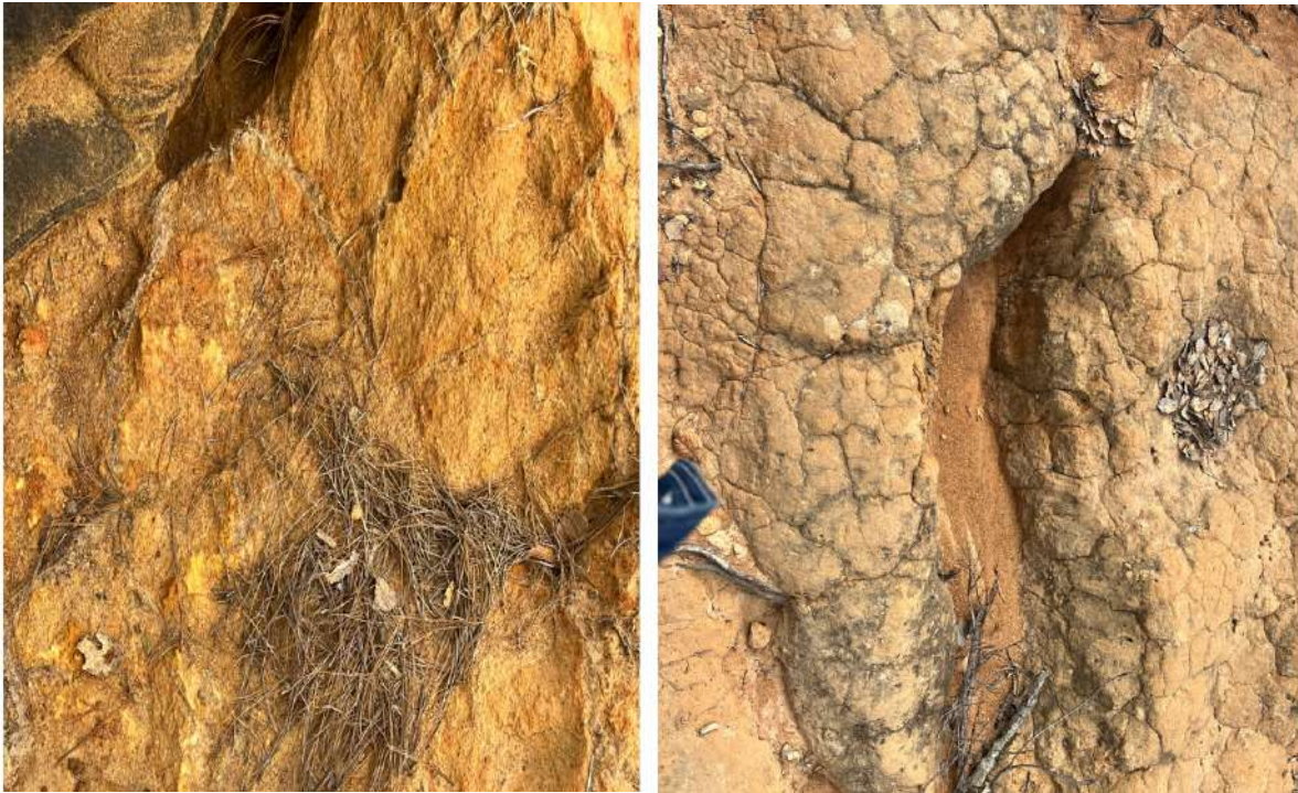
Figura 30. Erosión en surco y encostramiento en el sitio 3.
