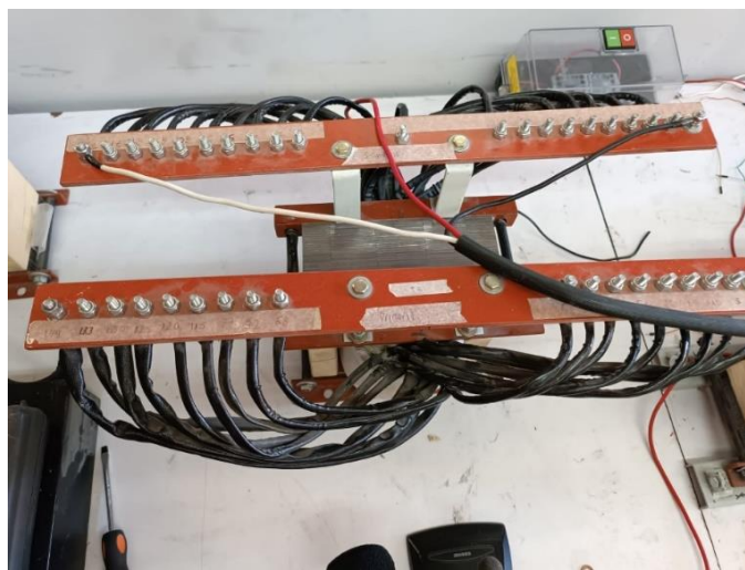
Fig. 14 Transformador tipo seco de baja potencia que se someterá al proyecto (autoría propia).
