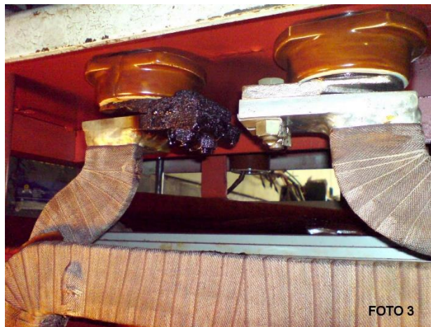
Fig. 8 Desgaste de conexión en transformador por cortocircuito (Bruno, L. G., 2009).
