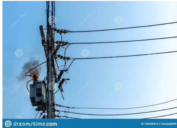
Fig. 7 Cortocircuito en transformador de baja potencia por sobrecarga (Rodríguez, 2023).
