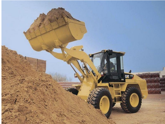
Figura 2.9. Cargador frontal en trabajos de colocación del material para acarreo del mismo ( Direct Industry ).
