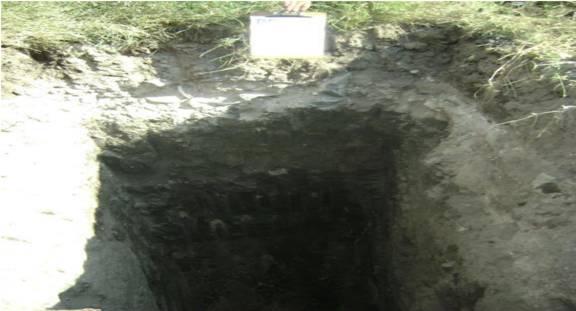
Figura 34.- Vista del sondeo no. 4. Se aprecia la capa de relleno constituida principalmente por material inerte (tepetate) empacando fragmentos chicos y medianos de roca. Bajo éste relleno se encuentra la arcilla inorgánica color café oscuro de consistencia media a firme
