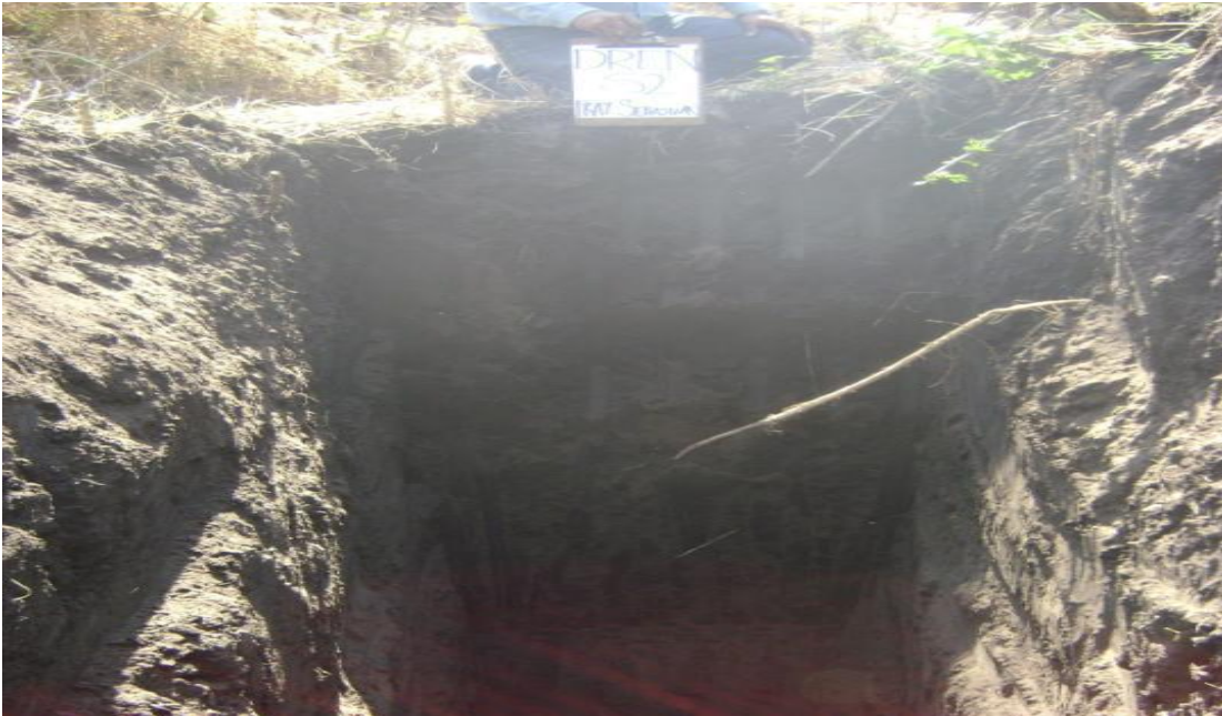
Figura 29.- Muestra el sondeo No. 2. Se aprecia el estrato de arcilla café oscuro inorgánica de alta plasticidad y de consistencia media a firme.
