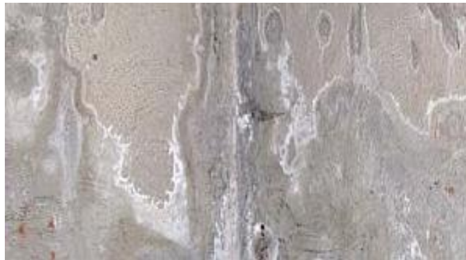
Fig. 1. Superficie de mortero con presencia de sales.
