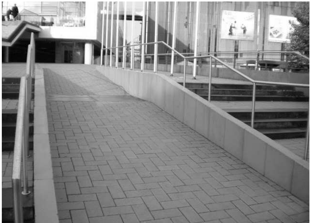
Figura 120. Rampa alternativa a escaleras en acceso a recinto. Feria Colonia, Alemania. Ciudades y espacios para todos. 2010
