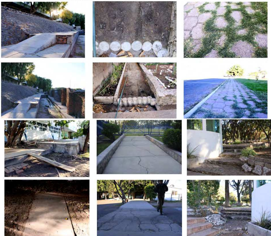
Figura 84. Estado de vías peatonales UAQ. Elaboración propia. 2011.
